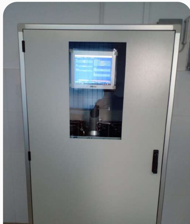
Analizor EasuChem montat in interiorul Statiei de Tratare Apa Potabila Chirita pentru monitorizare si avertizare timpurie
